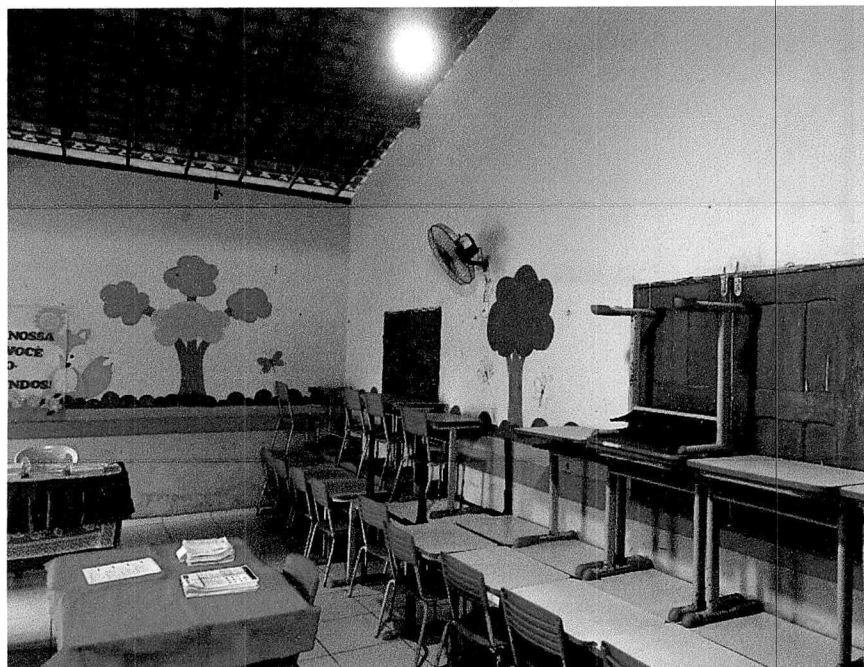
Imagem 19 – Pintura interna danificada
