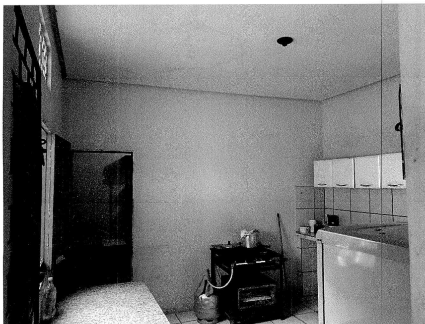
Imagem 22 – Pintura interna danificada
