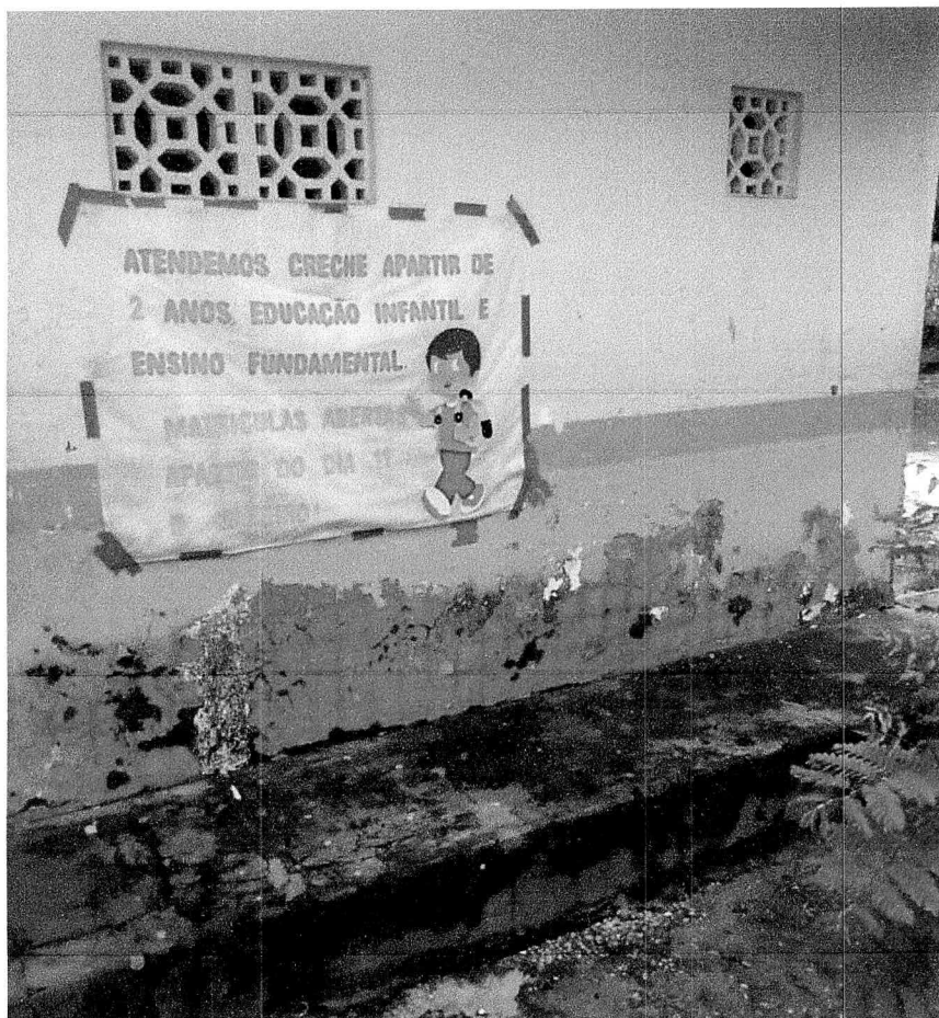
Imagem 15 – Pintura na entrada da escola danificada
