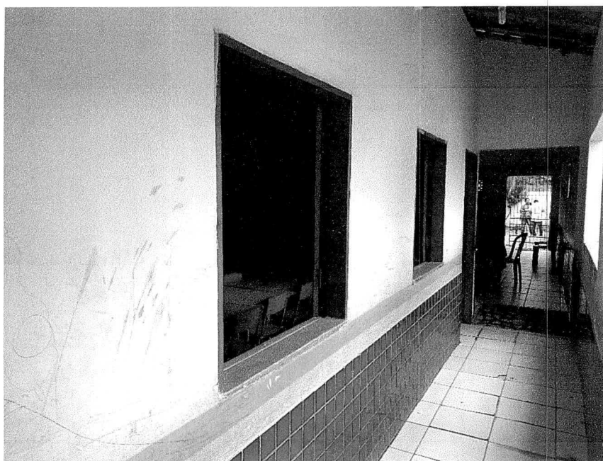
Imagem 26 – Pintura interna danificada
