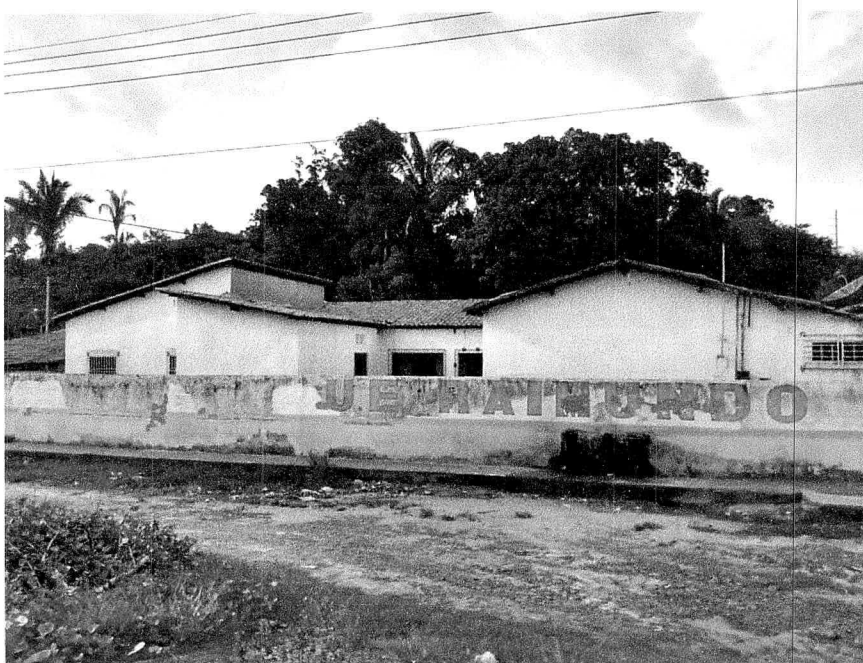
Imagem 2 – Pintura muro externo danificada
