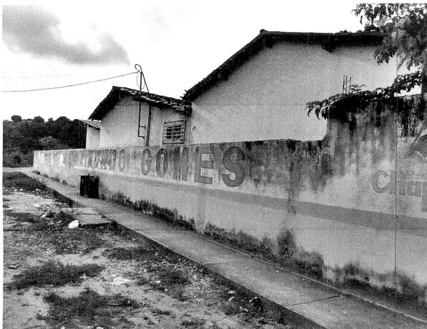
Imagem 1 – Pintura muro externo danificada
