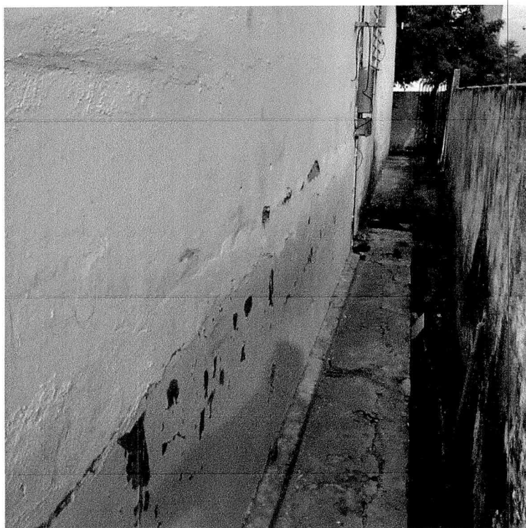
Imagem 7 – Fachada da escola com pintura danificada
