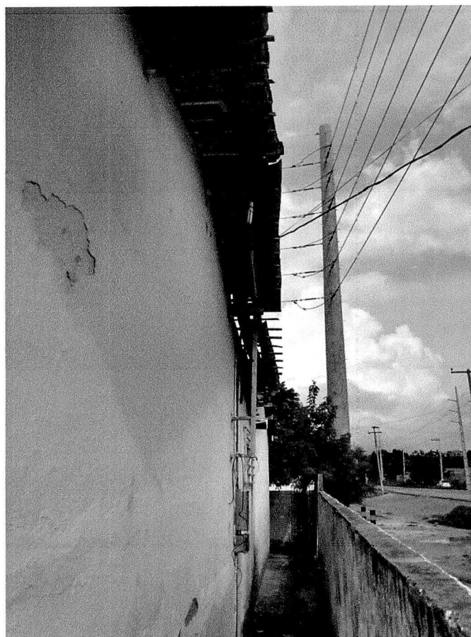
Imagem 8 – Fachada da escola com telhado danificado
