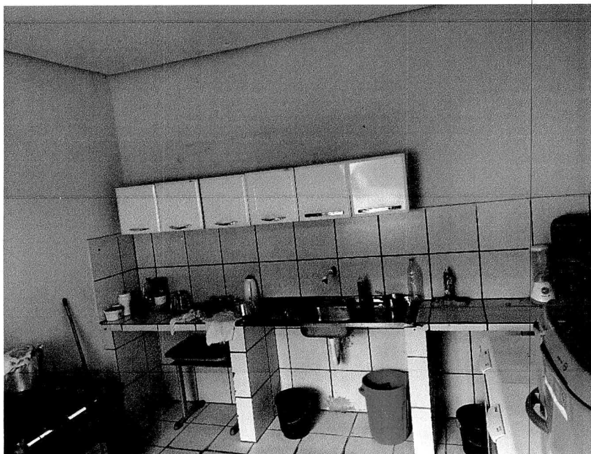
Imagem 23 – Cozinha com pintura danificada
