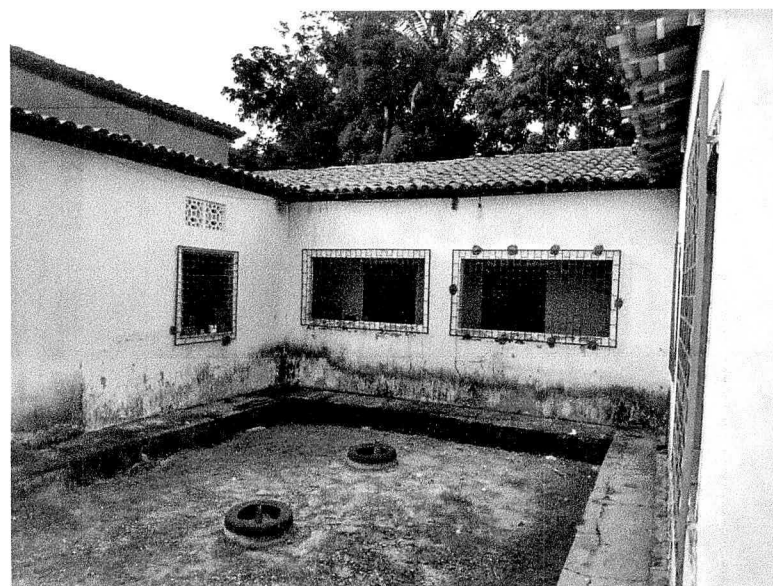
Imagem 14 – Pintura e telhado danificados
