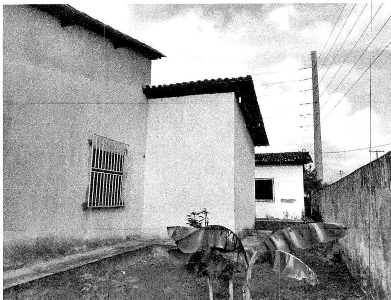
Imagem 9 – Fachada da escola com pintura danificada
