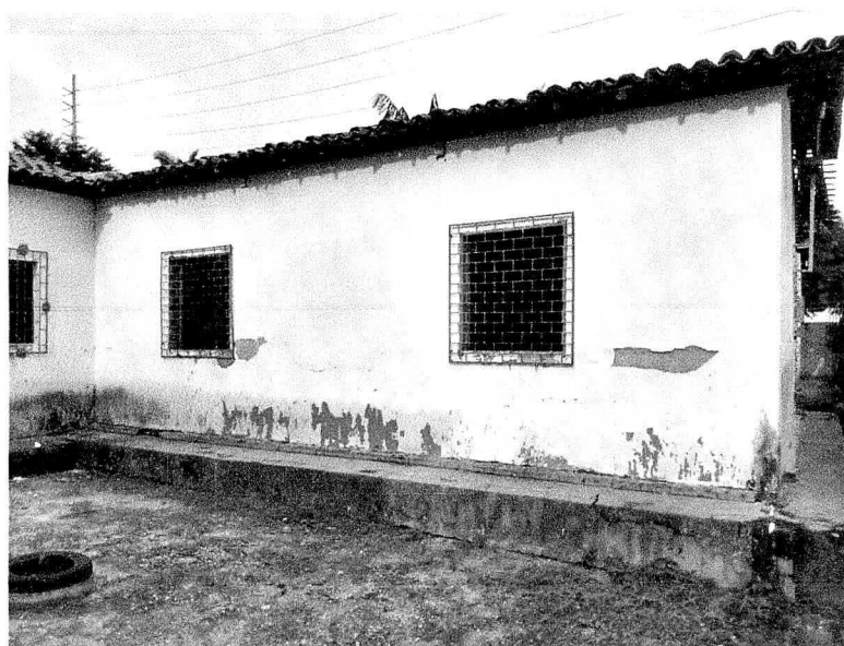
Imagem 13 – Pintura e telhado danificados
